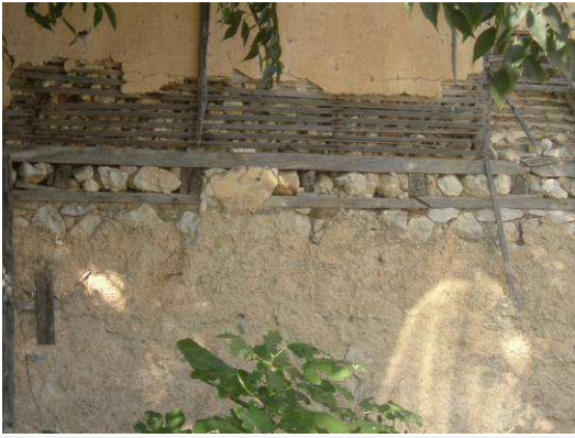
Εικόνα 19. Λεπτομέρεια κατασκευής ισογείου από πέτρα με ξύλινα δεσίματα και ορόφου από ξύλο (μπαγδατί). (πηγή: Προσωπικό αρχείο Α.Πασχαλίδου 21/10/2011)
